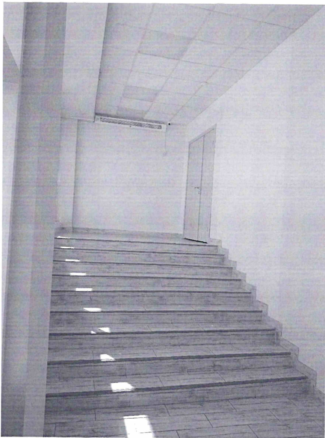
Фото 7. лестница в холодном коридоре
